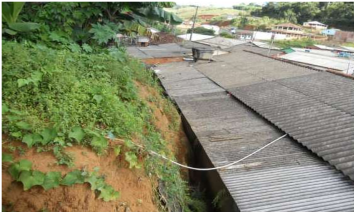
Figura 3. Foto tirada no Morro do Cristo Rei onde casas foram construídas sobre recortes feitos nas encostas. Fonte: Defesa Civil do Município de Porciúncula (RJ).
